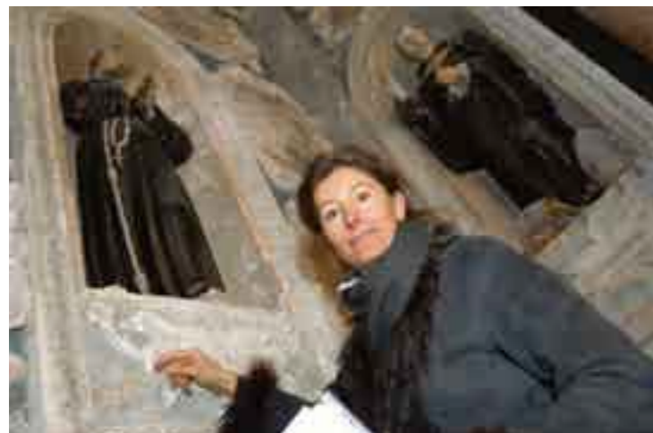
L'architetto Giacinta Jean mostra gli stucchi deteriorati nella cappella del Rosario, nella chiesa di San Francesco.
